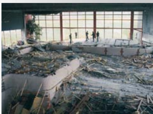
V roce 1985 povolil zavěšený betonový strop krytý plovárnou v Usteru, ve Švýcarsku. Stropní spojovací prvky z nerezavějící oceli nevykazovaly žádné vnější známky poškození, ale uvnitř byly v některých případech zcela zničeny v důsledku popraskání způsobeného korozi napětím
